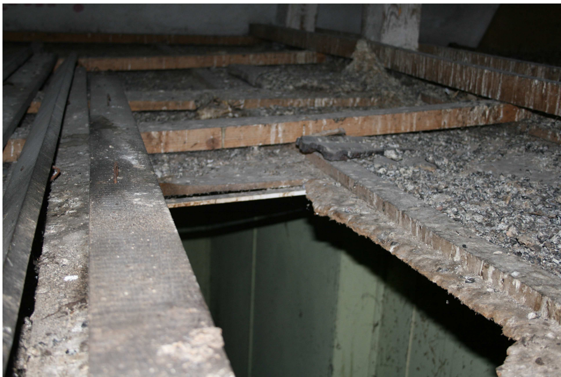
FOT. nr 9. STROP NAD PODDASZEM WPROWADZONY WTÓRNIĘ Z OTYNKOWANYCH PŁYT WIÓROWO – CEMENTOWYCH
