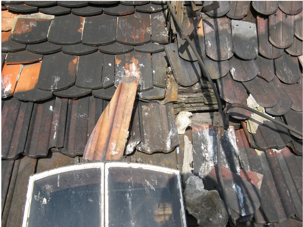
FOT. nr 11. WIDOCZNE ZNISZCZENIA I UBYTKI POKRYCIA DACHU
