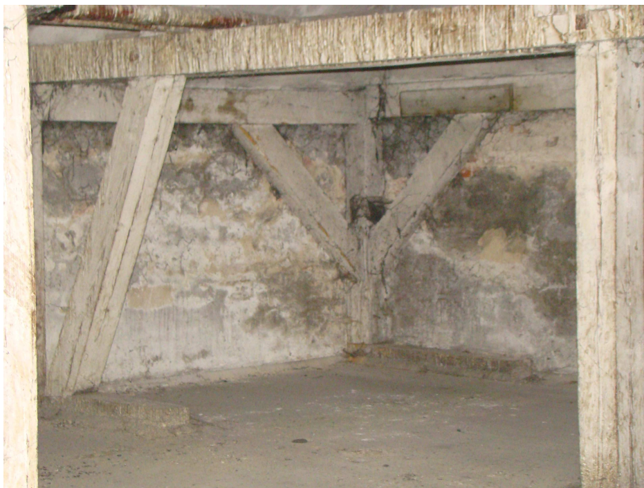
FOT. nr 6. ZAWILGOCONA ŚCIANA KOLANKOWA
