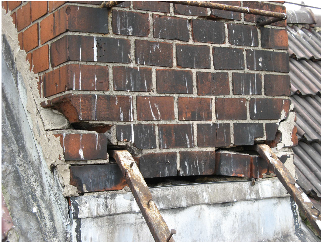
FOT. nr 22. ZNISZCZENIA MUROWANEGO KOMINA WRAZ Z POZOSTAŁOŚCIAMI PO EL. KOMUNIKACJI DACHOWEJ ŁAW KOMINIARSKICH
