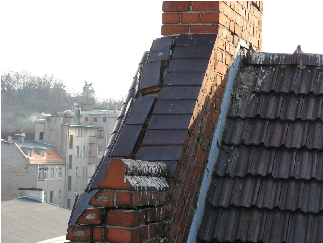
FOT. nr 19. WIDOCZNE ZNISZCZENIA ATTYK
