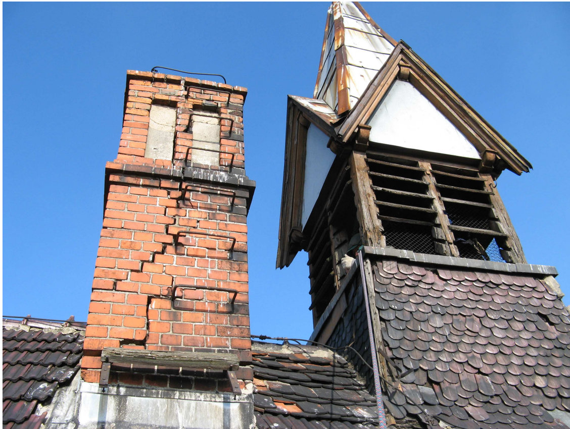
FOT. nr 17. WIDOCZNE ZNISZCZENIE MUROWANEGO KOMINA
