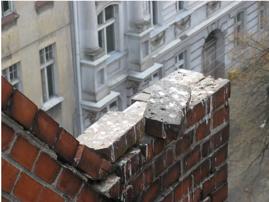
FOT. nr 20. WIDOCZNE ZNISZCZENIA ATTYK – UBYTKI CEGŁY GLAZUROWANEJ
