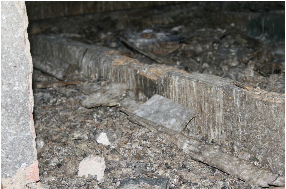
FOT. nr 12. WIDOCZNE ZNISZCZENIA STROPU NAD PODDASZEM
