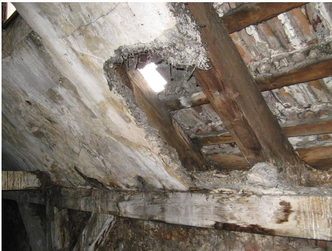
FOT. nr 13. WIDOCZNE ZNISZENIA KROKWI I ZAWILGOCENIA PŁATWI (MURŁATY)
