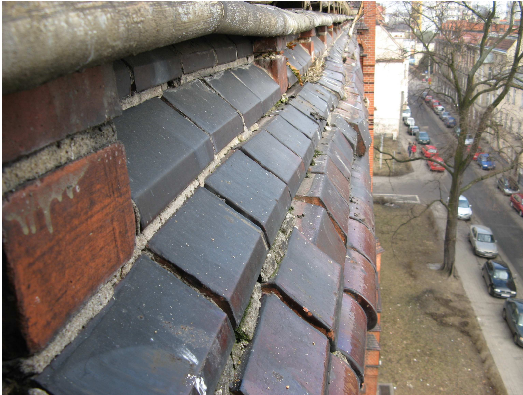
FOT. nr 7. ZNISZCZENIE GZYMSU OKAPOWEGO ELEWACJI FRONTOWEJ
