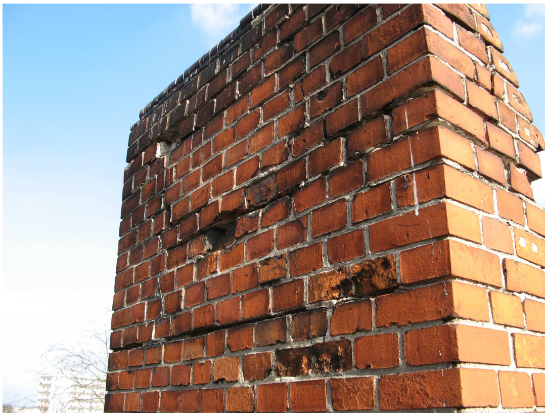
FOT. nr 18. WIDOCZNE ZNISZCZENIA ŚCIANKI ATTYKOWEJ
