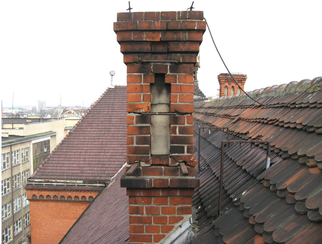
FOT. nr 21. WIDOCZNE ZNISZCZENIA MUROWANEGO KOMINA WRAZ Z POZOSTAŁOŚCIAMI PO EL. KOMUNIKACJI DACHOWEJ ŁAW KOMINIARSKICH
