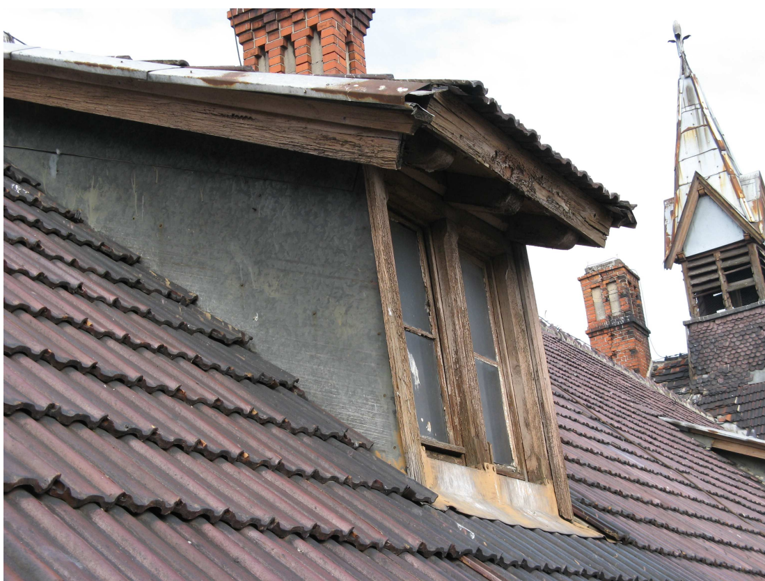
FOT. nr 16. WIDOCZNE ZNISZCZENIA LUKARNY DACHOWEJ
