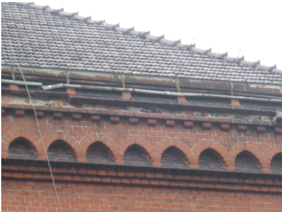
FOT. nr 8. ZNISZCZENIE GZYMSU OKAPOWEGO ELEWACJI POŁUDNIOWEJ
